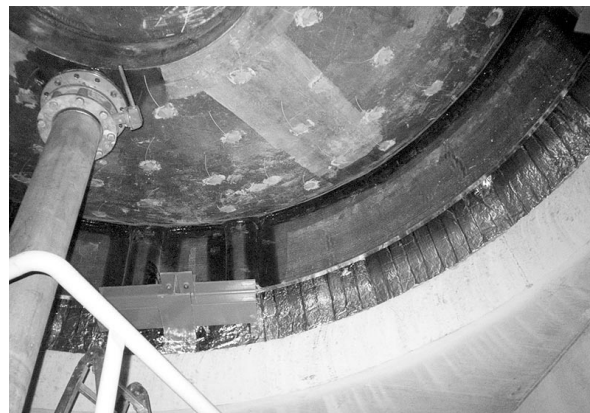
Abb. 13: GFK-Schornstein von unten
